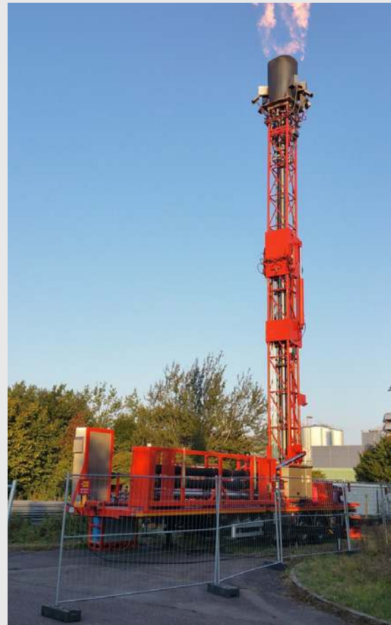
Bild 4: Fackel bei der Entlastungsarbeit
